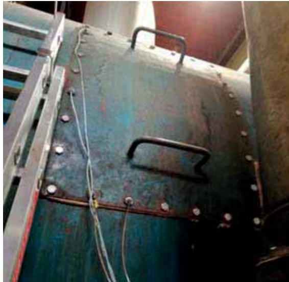
Slika 6.7 - Način izvođenja sondi iz kotla i hermetičko zatvaranje kotla
