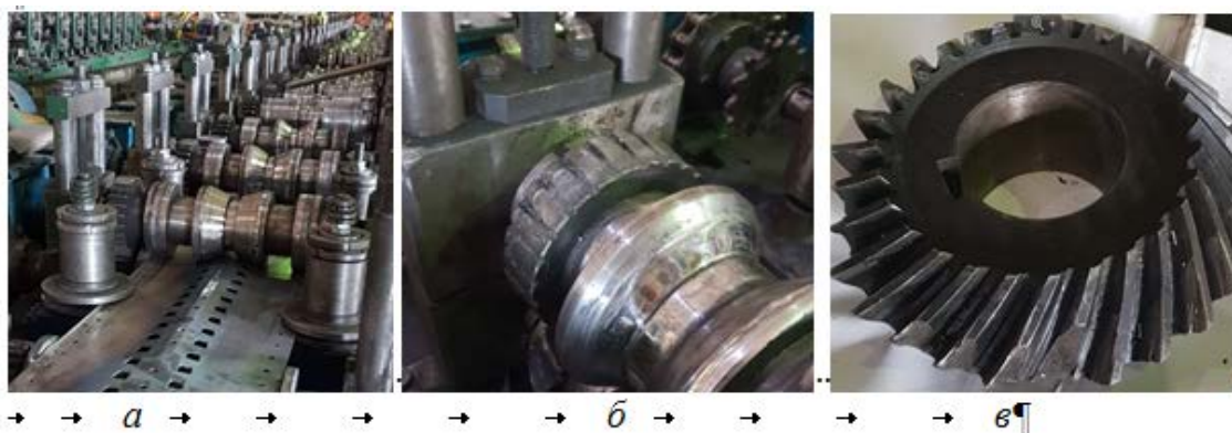
Рис.2. Профілезгинальний стан і руйнування елементів його приводу
